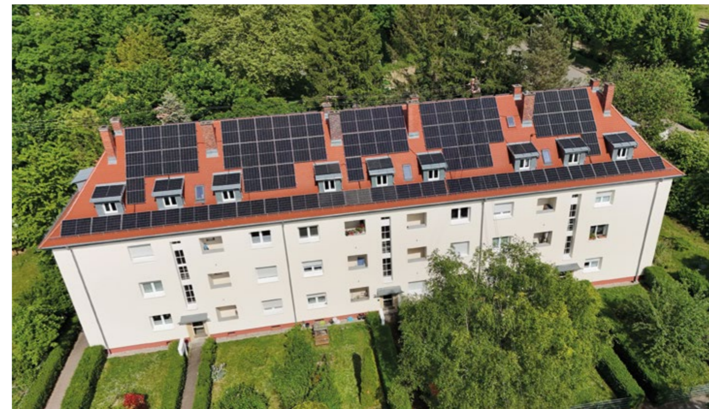
Photovoltaik-Anlage in der Millöckerstraße
